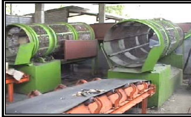
Gambar 7.6. Instalasi Pengolahan Sampah Tuntas (IPESATU)
